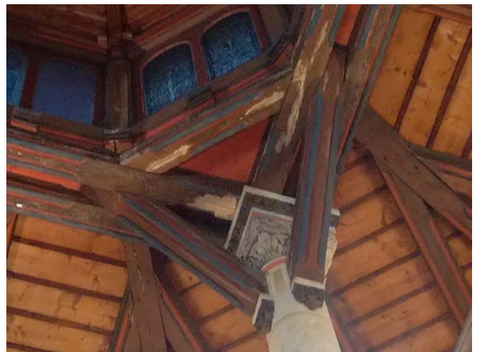
Beschädigung des Dachstuhls (Foto: Henning Frase)
